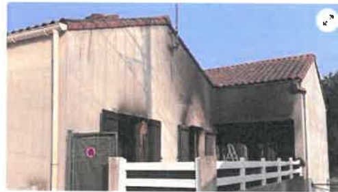
La maison, qui comprenait trois logements, a été totalement détruite par les flammes. © OUEST-FRANCE
